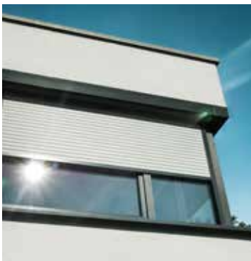
Vorbaurollladen QUADRO flächenbündig mit der Fassade montiert.
